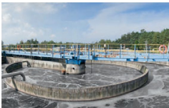
Wasseraufbereitungsanlage, Quelle: envato elements
