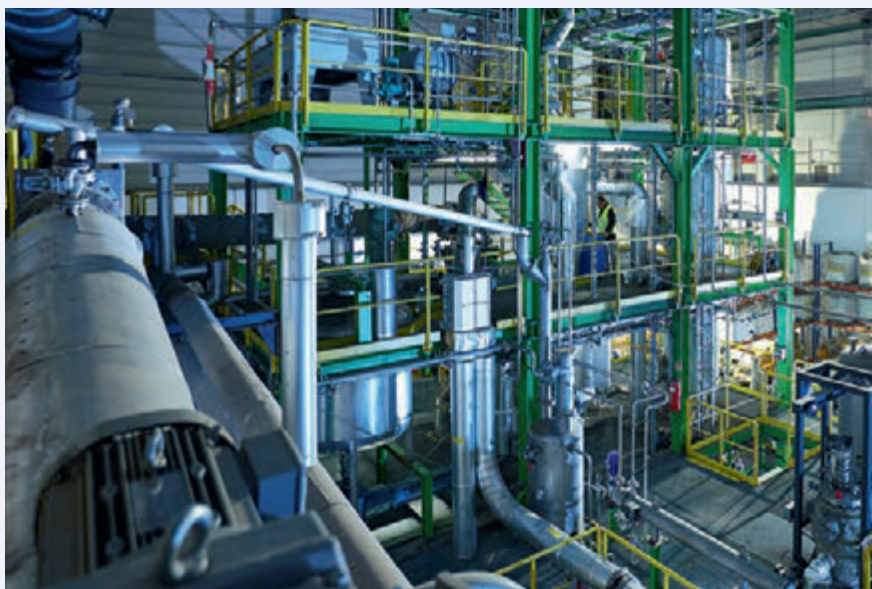
Pilotanlage in Ennigerloh, Quelle: Carboliq
