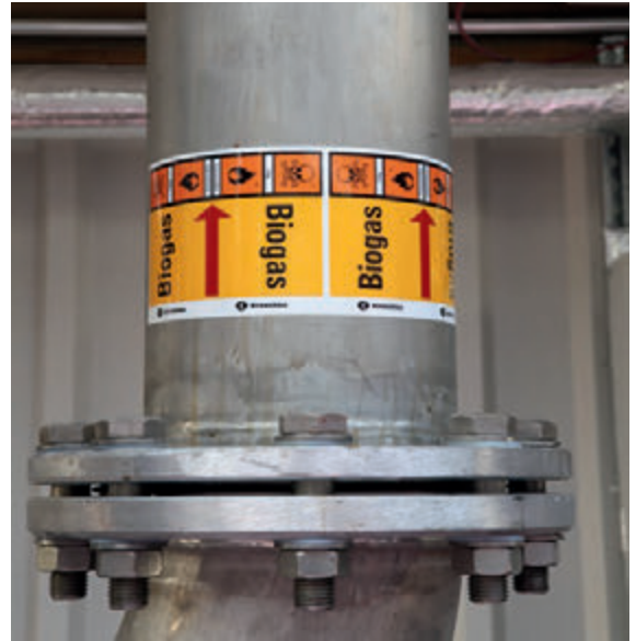
Rohrleitung Biogas, Quelle AWG
