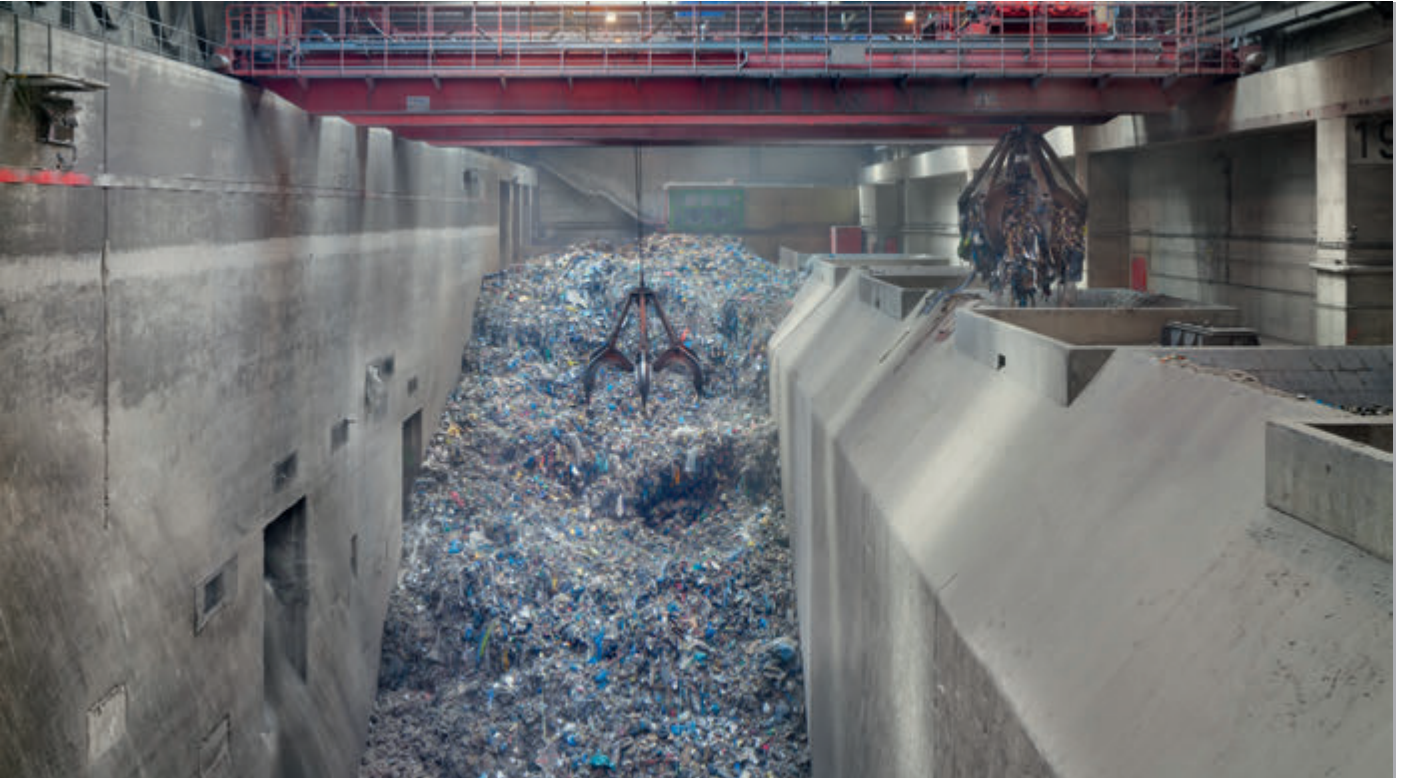
Bunker der Restmüllverbrennungsanlage Köln, Quelle: AVG Köln
