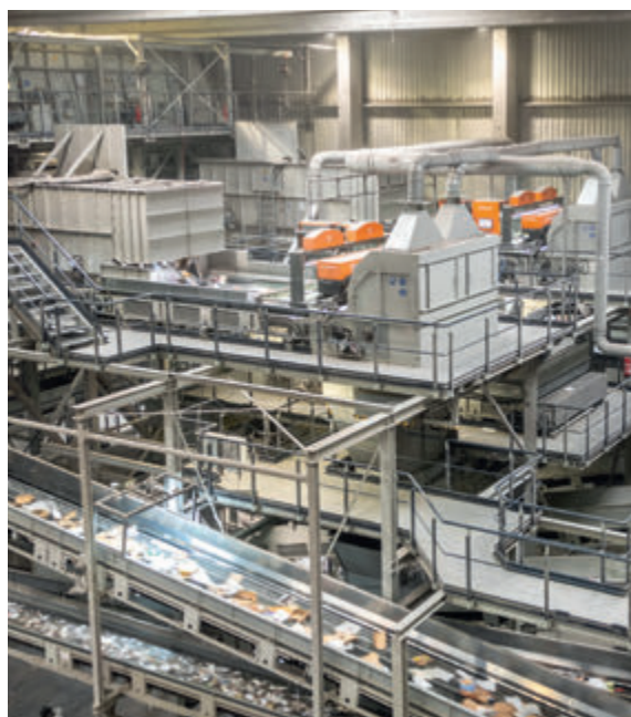
Altpapiersortieranlage, Quelle: Römbke AVG Köln
