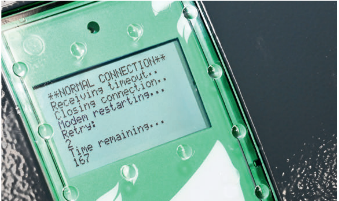
Zugangskontrolle, Quelle: Newwaste
