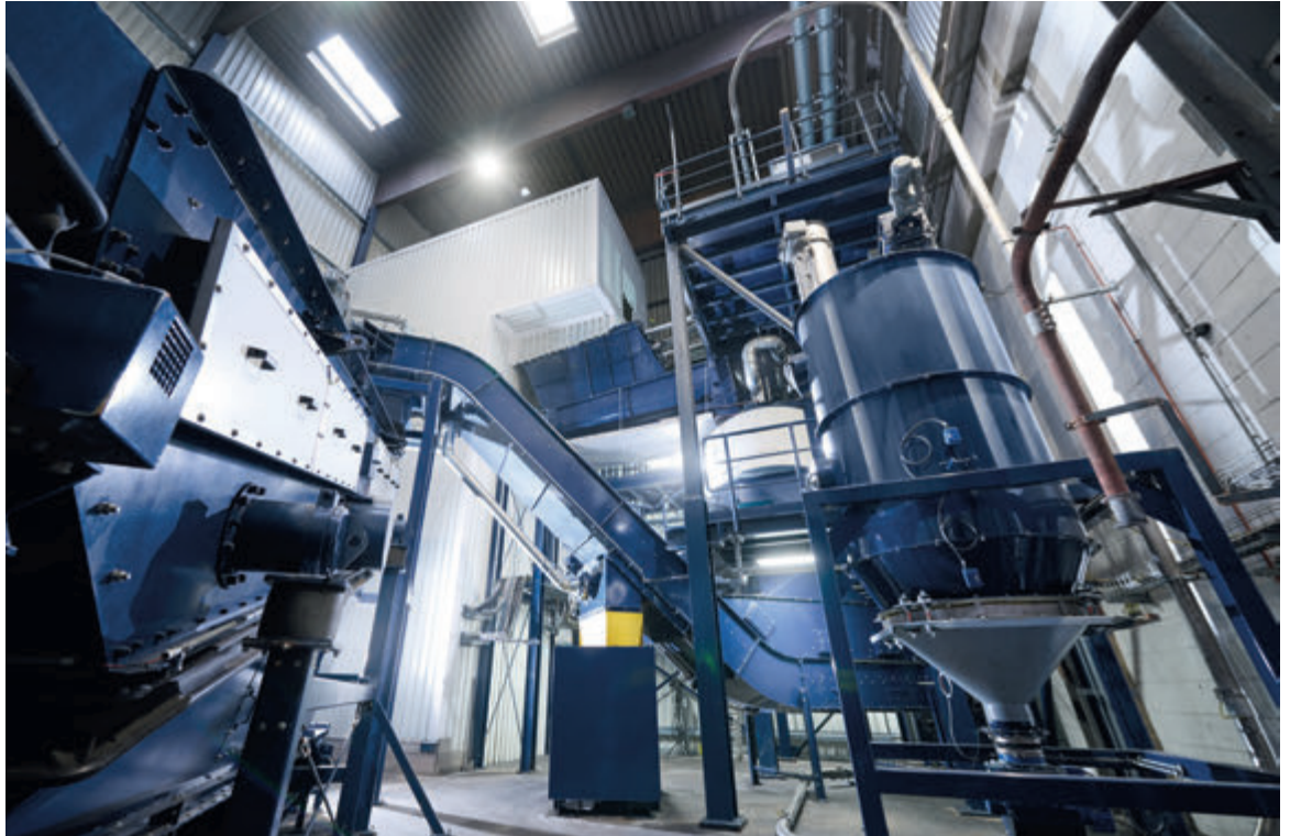
Sonderabfallverbrennung in Bramsche, Quelle: REMONDIS
